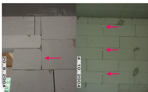
Zu große Abstände zwischen den Ziegeln, die nicht eingemörtelt sind. Hierdurch sinken die Tragfähigkeit sowie die Eigenschaften des Wärme- und Schallschutzes.
