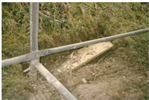
Der Gerüststiel wurde unsachgemäß auf einem nicht standfesten Boden abgesetzt.
