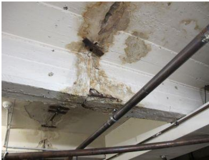
Undichte Gebäudetrennfuge zwischen Fertigbauteilen.
