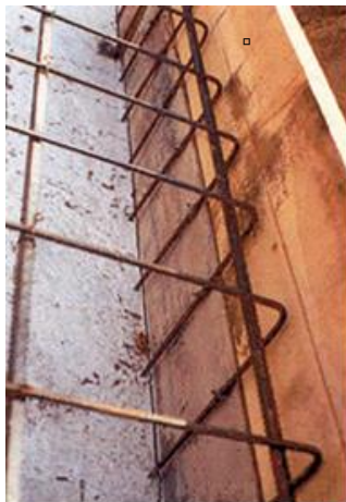
Keine Betondeckung des Bügelkorbes
