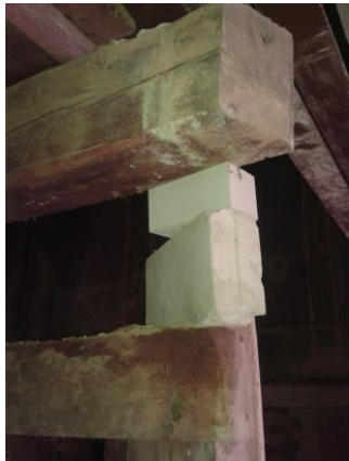
Die bauzeitliche Abstützung für den Dachgeschossausbau bestand aus zwei seitlich versetzten Kalksandsteinen. Aufgelagert waren Stahlträger der Dachkonstruktion.
