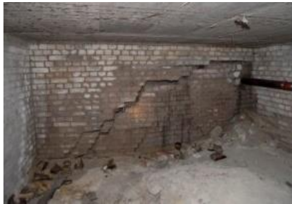
Rissbildung infolge Gründungsversagen.
