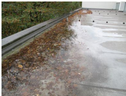
Wasseranstau auf einem Flachdach durch fehlerhafte Entwässerung.
