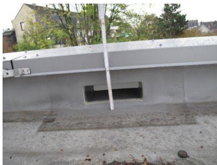
Der Notüberlauf in der Randaufkantung des Flachdaches ist von der höhenmäßigen Anordnung auf die planmäßige Entwässerung abzustimmen.
