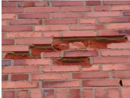
Frostschäden an einem Klinkermauerwerk.
