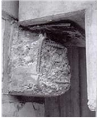
Schaden an einer Konsole wegen falscher Lageranordnung oder fehlender Bewehrung.
