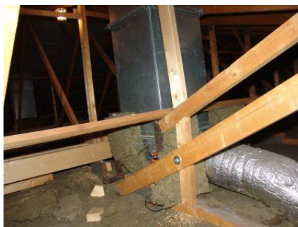
Durch die herausgesägte Fachwerkdiagonale, ist die Standsicherheit der Konstruktion massiv gefährdet.
