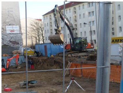
Ein unmittelbar an einer senkrechten Baugrubenwand stehender Bagger führte Schachtarbeiten durch.
