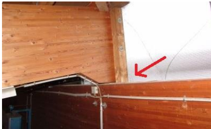
Spalt zwischen Nebenträger und Hauptträger wurde mit einem losen Holzstück geschlossen.
