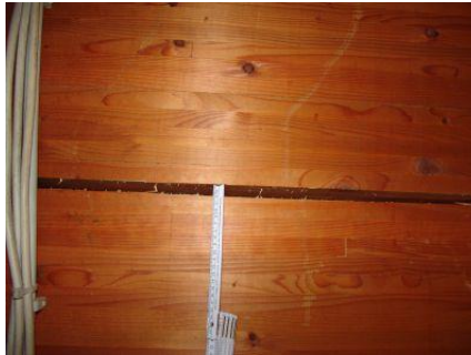
Breiter Horizontalriss entlang einer Leimfuge.
