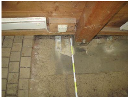
Verschobener Wandstiel infolge Holzschwindens.
