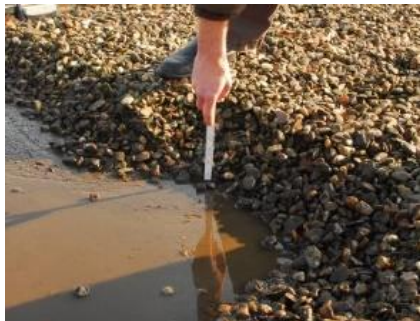
Überlast aus zu dicker Dacheindeckung aus Kies.
