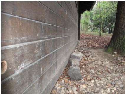
Verformte Seitenwand infolge von Schwind- und Temperaturbeanspruchungen.
