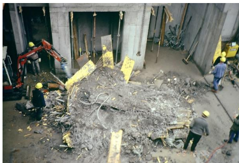
Versagen der stützenden Konstruktion der Stahlbeton-Deckenplatte.
