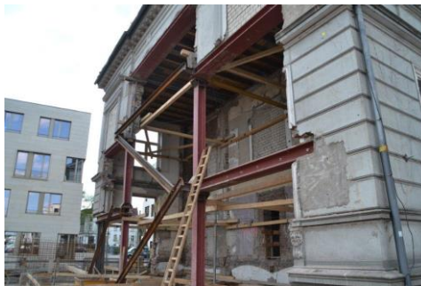
Bei dieser komplexen Bauwerkssicherung wurde ein vertikales Tragwerk aus Stahl ausgeführt. Die horizontale Stabilisierung wurde vernachlässigt und nur unzureichend als Holzverstrebung angeordnet.
