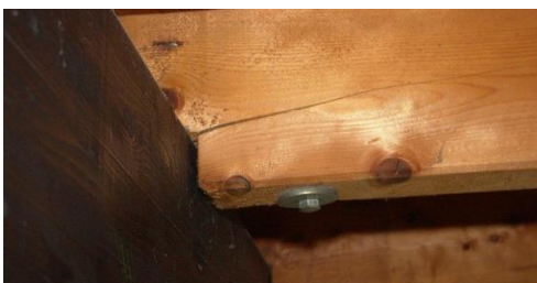
Einriss des Vollholzträgers auf Höhe der Ausklinkung wegen nicht randnah eingebauter Querzugverstärkungen.
