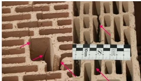
Risse im Ziegel führen zu einem sinkenden Wärmeschutz (bei Dämmziegeln) und zu möglichen Feuchteproblemen durch Kapillarfeuchtigkeit. Bei großen Rissen ist auch eine geminderte Tragfähigkeit anzunehmen.
