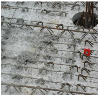
Der Beton im Durchstanzbereich ist fast bis zur Oberkante der Gitterträger eingebracht worden, wodurch die obere Deckenbewehrung nicht eingebaut werden konnte. Somit ist die Standsicherheit der Decke nicht mehr gegeben. (Der Transport der Fertigteilplatte zur Baustelle hätte gar nicht erst erfolgen dürfen).
