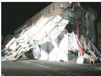
Die fehlende Verankerung des Gerüsts am Gebäude führte bei einer mittleren Windbeanspruchung zum Einsturz. Zusätzlich war eine nicht vorgesehene Plane angebracht.
