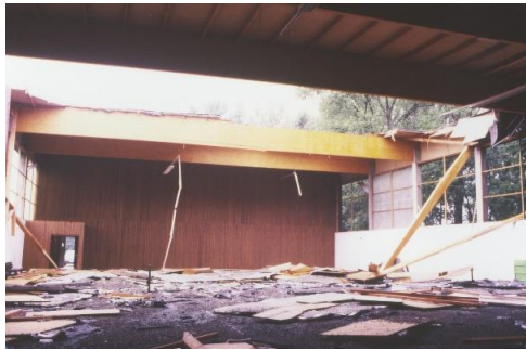
Versagen eines Dachträgers einer Sporthalle.
