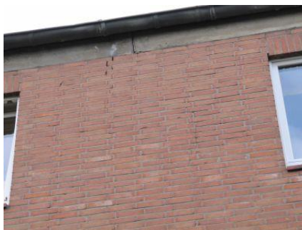
Schäden an einer Fassade durch inkonsequente Fugenanordnung.
