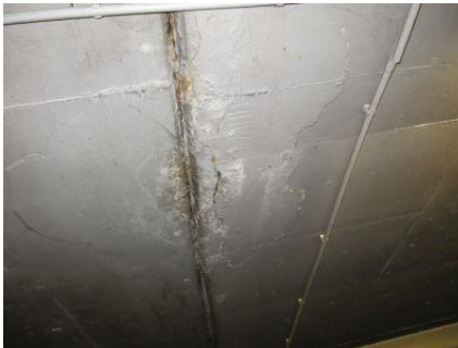
Ausbrüche und Ausblühungen an undichter Gebäudefuge.
