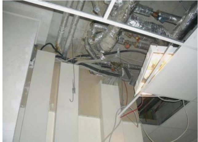
Abb. 13b: ... im Trockenbau stellen keine Gefahr, aber ein wirtschaftliches Risiko für den Bauherren dar.
