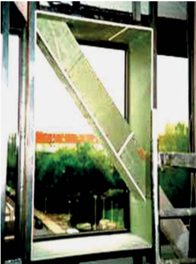
Abb. 1: Der geplante Rettungsweg wird von einer tragenden Fassadenstrebe durchkreuzt.
