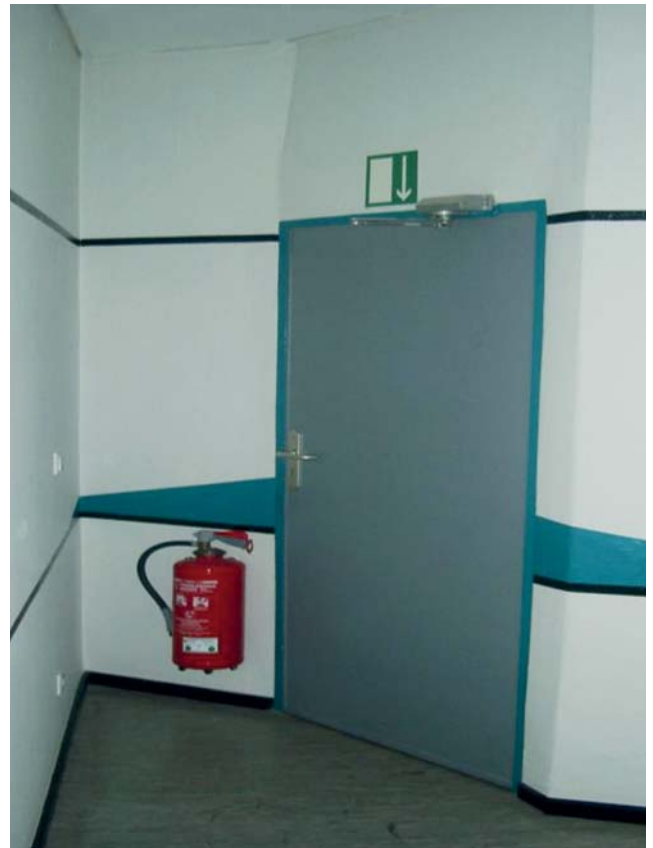
Abb. 2: Die Tür schlägt im Brandfall dem Fliehenden entgegen und blockiert den Rettungsweg.
