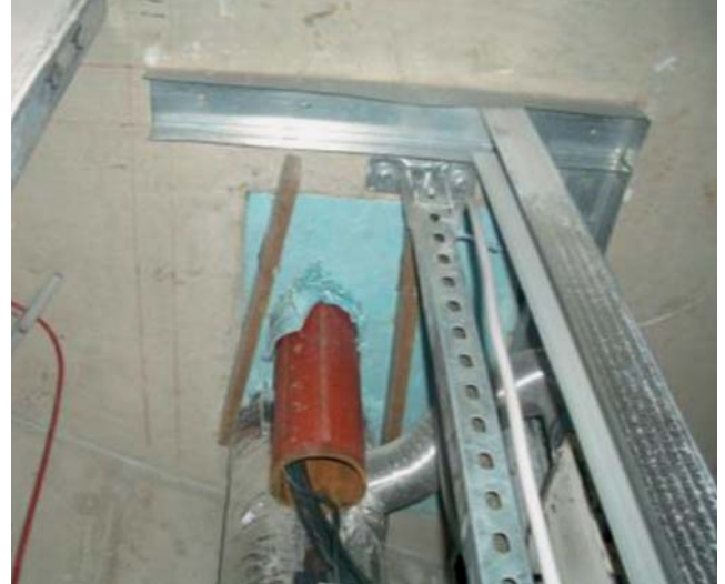
Abb. 8a: Trockembaufehler: fehlende Trennstreifen ... Figure 8a: Dry construction faults: missing separating strips, ...
