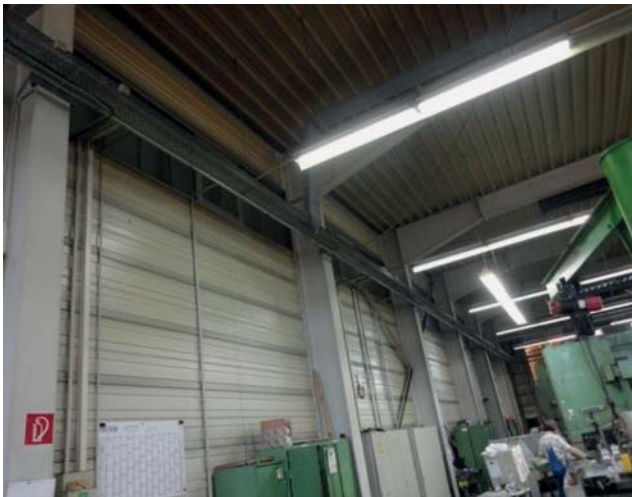
Abb. 6a: Diese Aussteifung der Brandwand durch brandschutztechnisch ungeschützte Bauteile ist unzulässig, weil sie in Verbindung ... Figure 6a: This bracing of the fire wall by components without fire protection is impermissible, because, when used in conjunction ...
